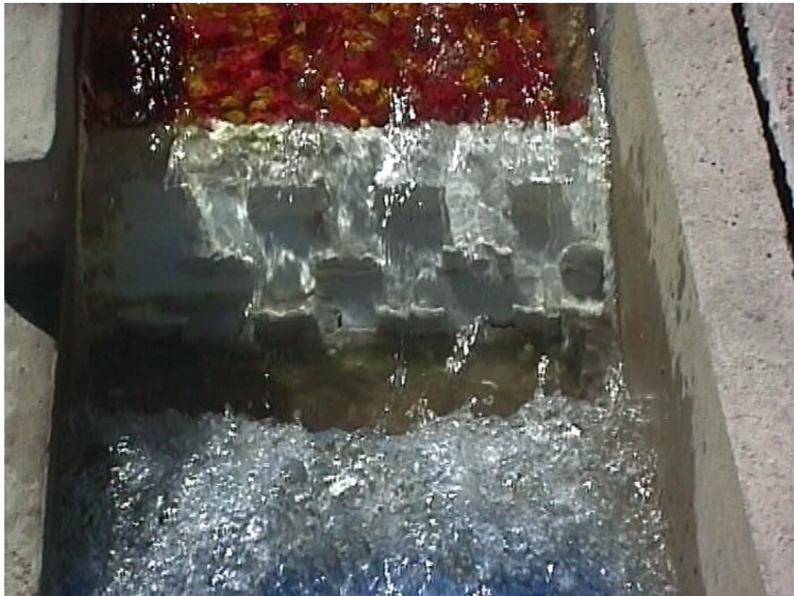
FOTO 59.- Adecuado funcionamiento de la estructura de disipación de San Gabriel para el caudal de proyecto.
