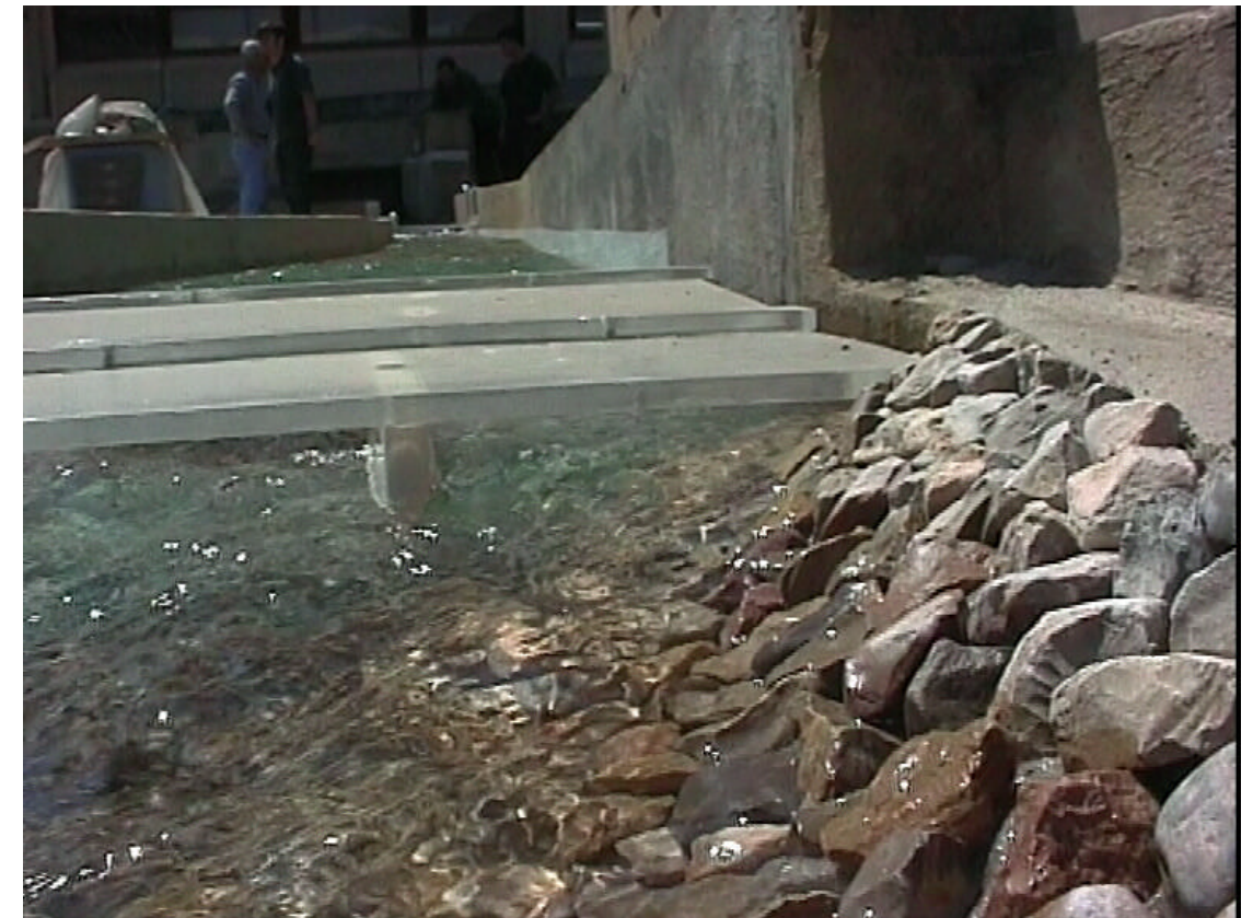
FOTO 45.- Salida del flujo bajo el vano de la margen izquierda. Se aprecia el aumento de resguardo conforme nos alejamos de la zona problemática.
