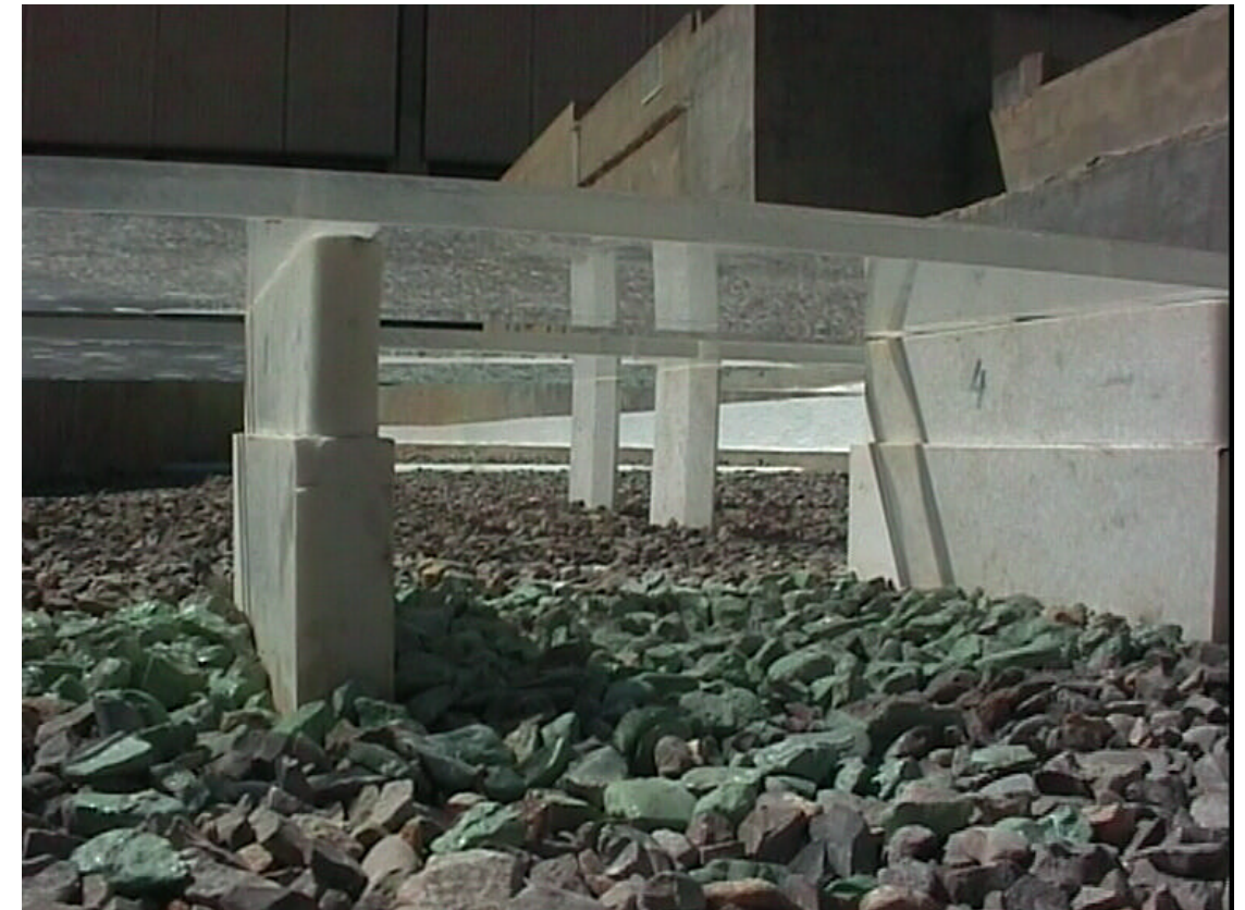
FOTO 22.- Vista desde aguas abajo, del efecto de esvía e interferencia de las pilas respecto de la dirección principal del flujo en avenida.
