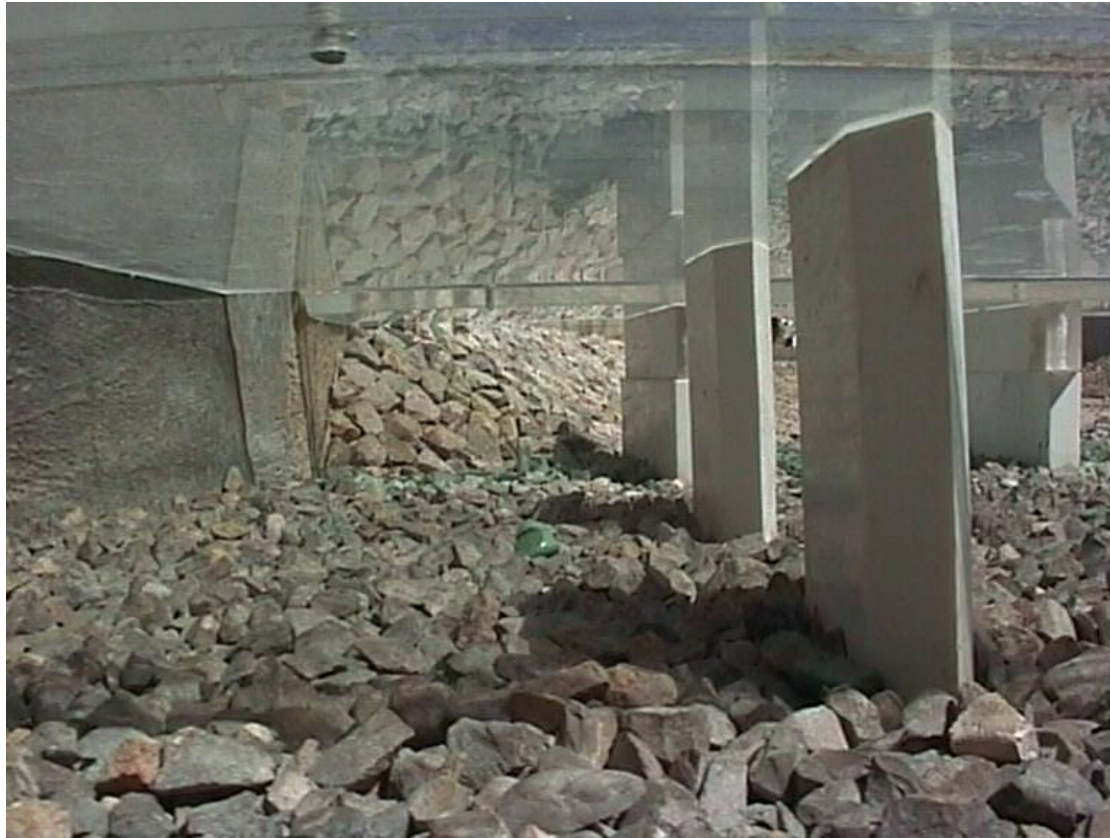
FOTO 19.- El vano de la m. izquierda de ambos puentes apenas dispone de salida por el efecto del derrame del dique-espigón marítimo (al fondo).
