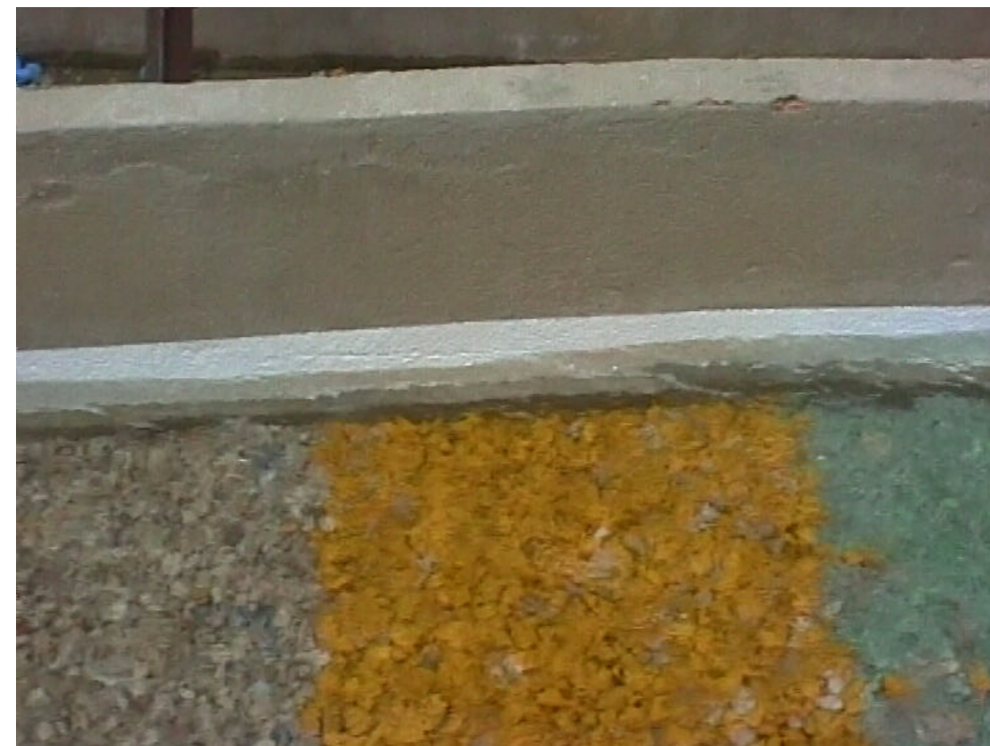
FOTO 97.- Resguardo en el entorno de la rampa entre plataformas a cota -1.00 m. y -2.00 m.
