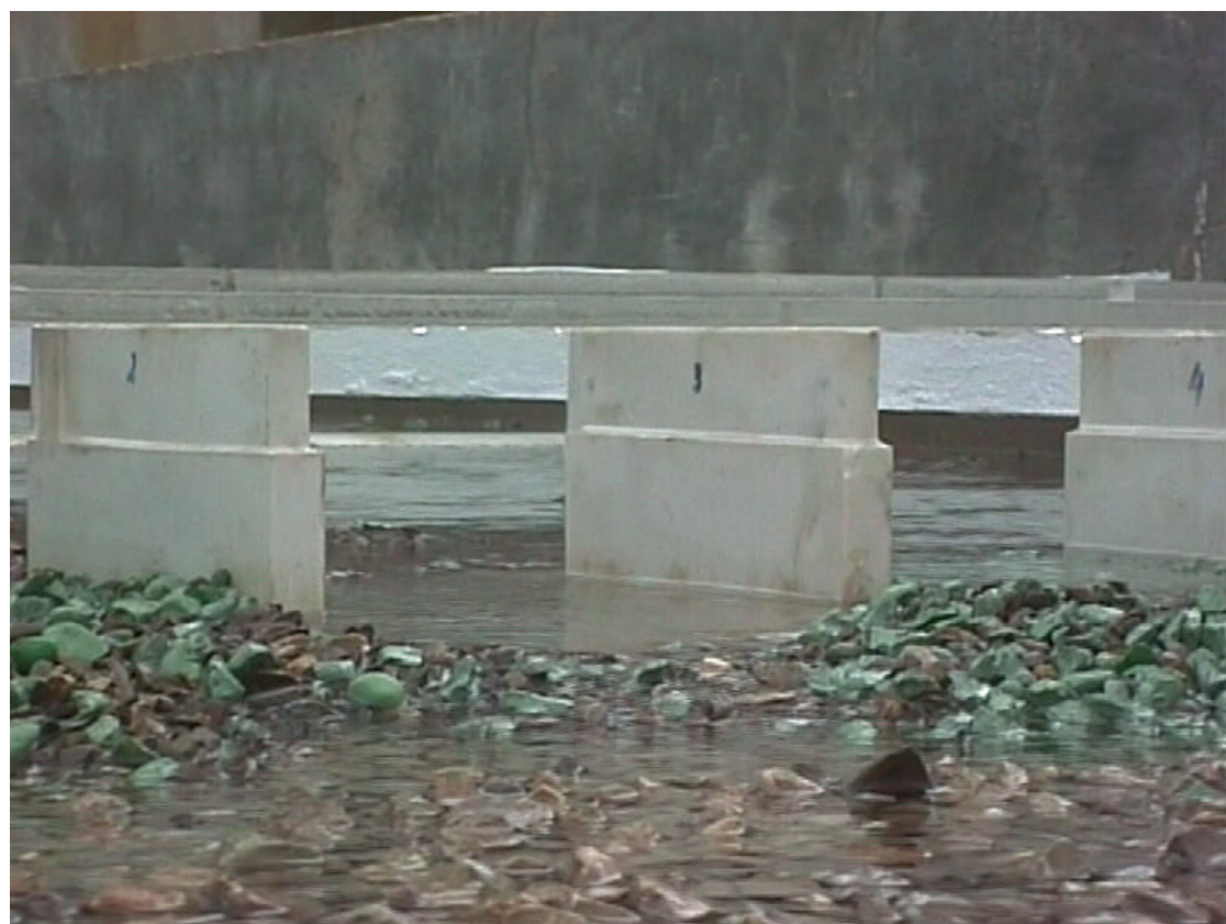
FOTO 80. Grandes zonas de socavación localizada cerca de la margen derecha del cauce en la salida del puente del ferrocarril.
