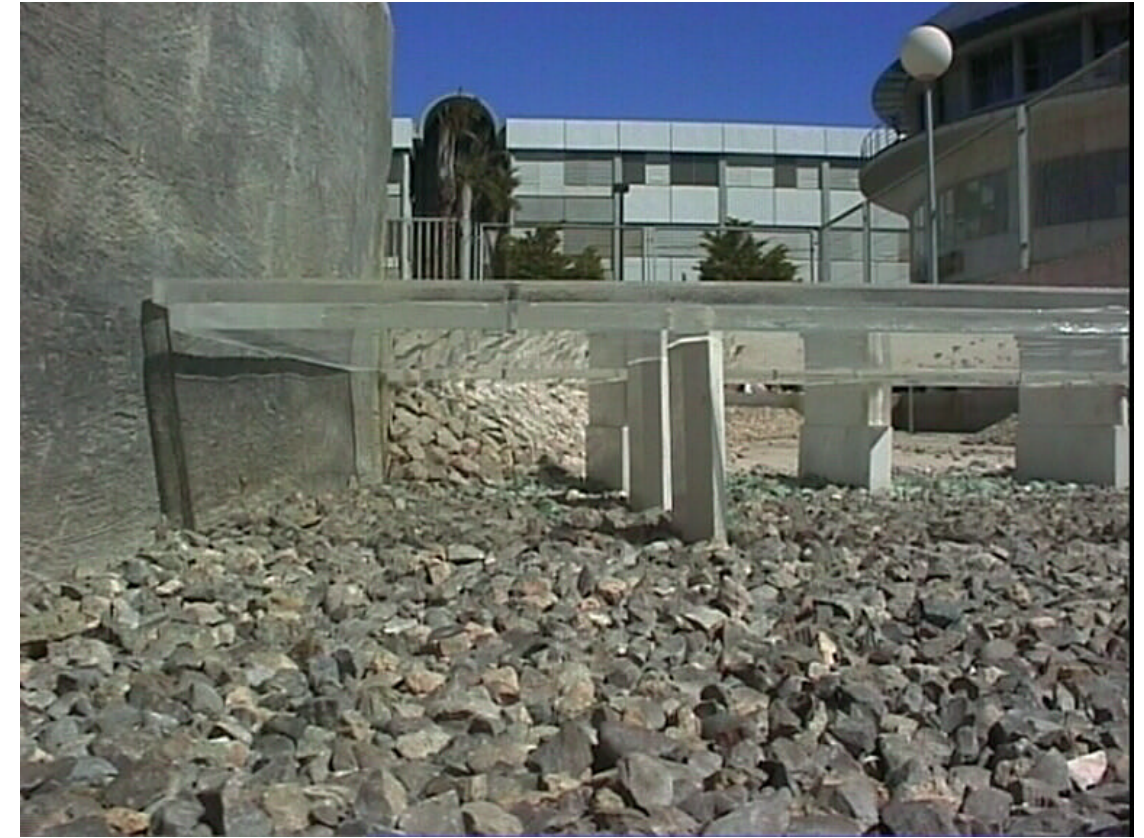
FOTO 17.- Vista desde la margen izquierda del cauce, del efecto de cierre que genera (al fondo) el arranque del dique-espigón sobre los vanos de los puentes.
