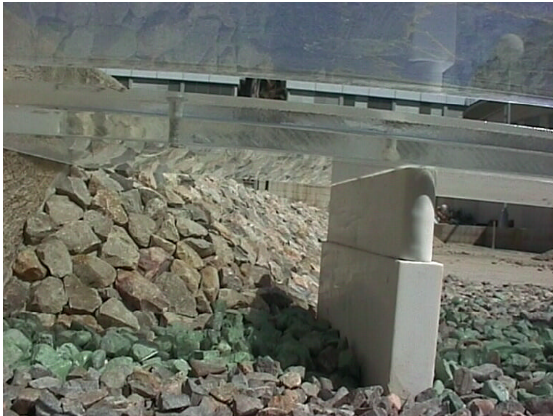
FOTO 20.- Primer plano de la interferencia del talud del espigón con el vano del puente del ferrocarril.
