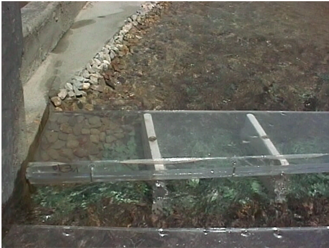
FOTO 52.- Nueva vista de la entrada en carga del vano de la margen izquierda del puente del ferrocarril por efecto del cierre generado por el dique-espigón.
